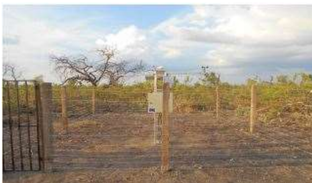
Figura 4 - Estação Solarimétrica instalada na área do projeto Fonte: Memorial Descritivo UFV Jardim, 2022.
