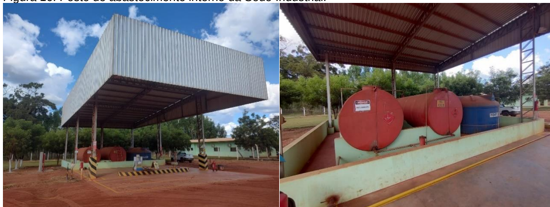
Figura 16: Posto de abastecimento interno da Sede Industrial.
