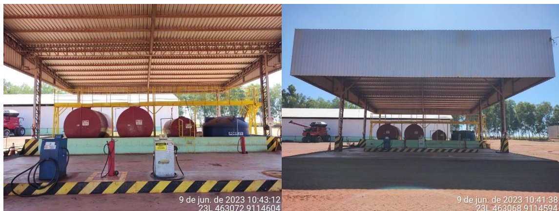
Figura 17: Posto de abastecimento interno da Sede Operacional.
