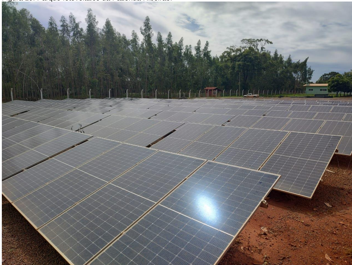
Figura 19: Parque fotovoltaico da Fazenda Ribeirão.
